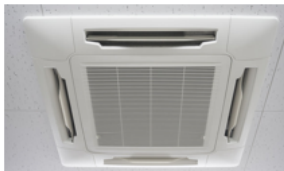
業務用エアコンが設置されている場所
